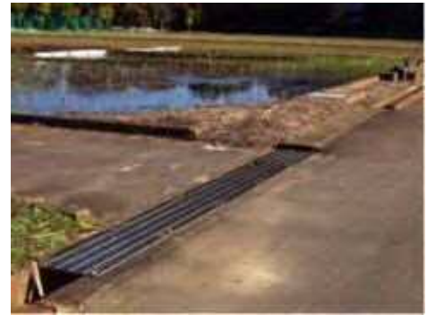
コンクリート蓋とグレーチング
