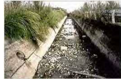
水量が減少した水路
