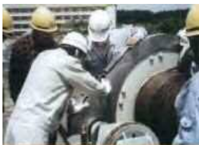
ポンプ点検状況
