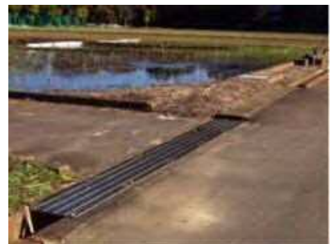
コンクリート蓋とグレーチング
