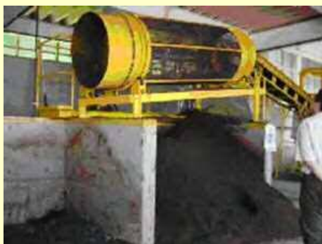
堆肥プラント
