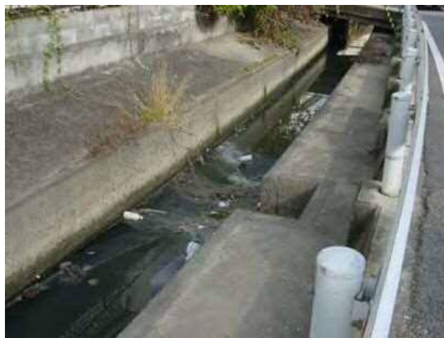
非かんがい期で通水が停止し、雨水のみが滞留して水質が悪化した農業用水路（周辺は新興住宅地）
