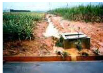
土砂の流出状況
