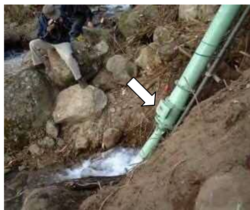
簡易な発電機 (図の矢印)
