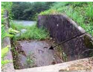
洪水吐底板（コンクリート）の欠損
