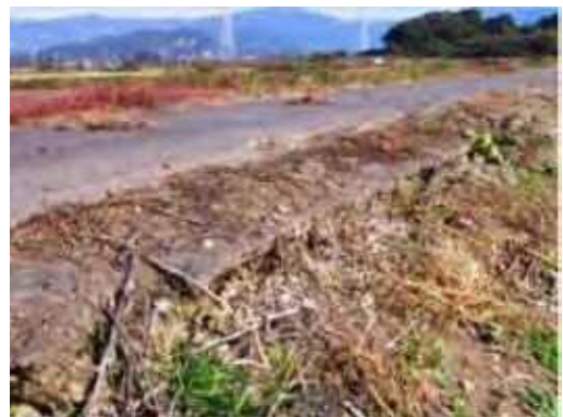
路肩の浸食と路面下の空洞
