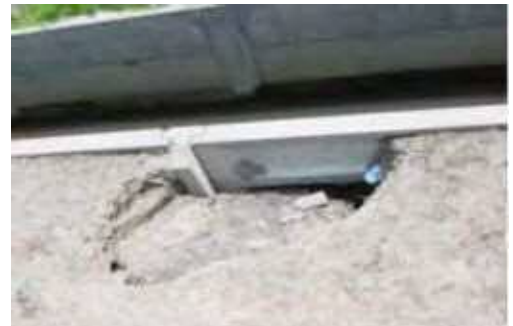
水路側壁の空洞状況
