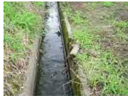
破損したU字溝
