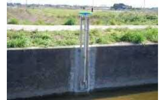
巻き上げ式ゲート（分水用ゲート）
