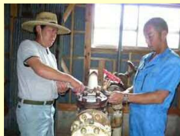
ポンプの点検状況
