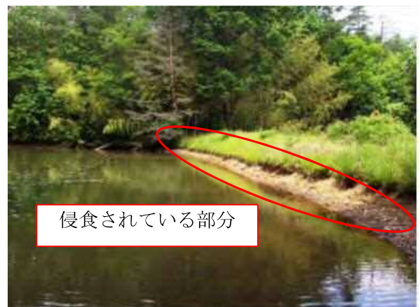
侵食が生じているため池堤体
