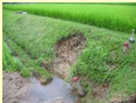
農用地法面が崩れた状況
