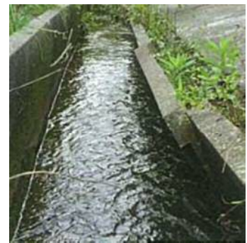
側壁の倒壊（側溝）
