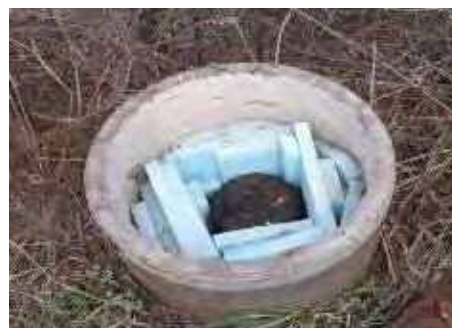
給水栓ボックス内の保温状況
