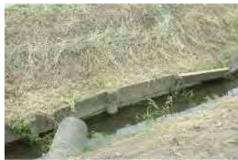
水路側壁のはらみの状況
